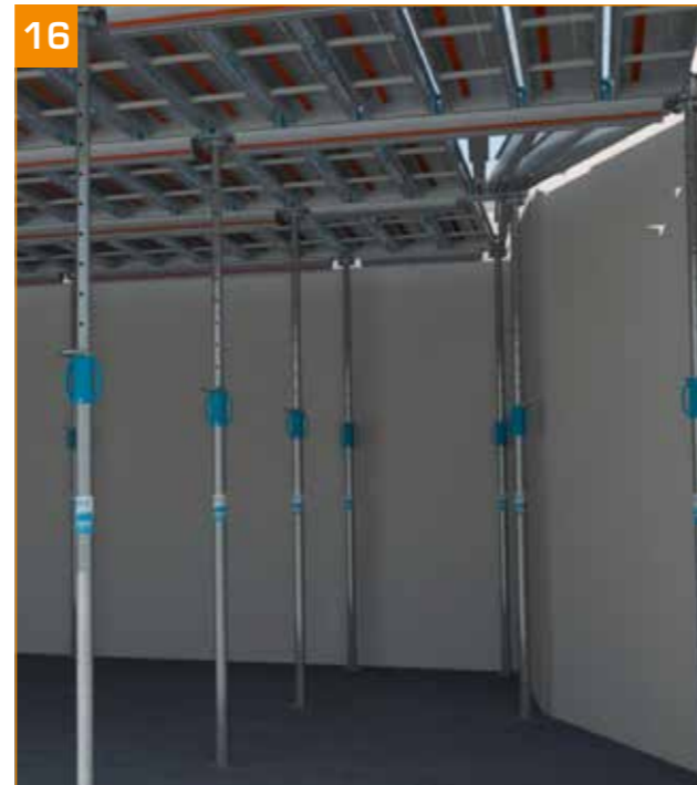
16 - Affiner la mise à niveau à l'aide d'un niveau laser ST par ST. - Une pige suspendue au coffrage permet à un seul homme d'effectuer le réglage avec le niveau laser. - Effectuer un dernier contrôle du verrouillage des têtes à cette étape.
